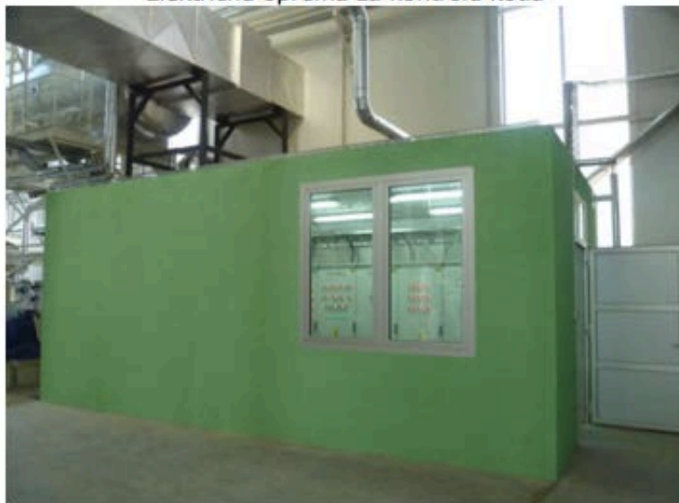
Električna oprema za kontrolu kotla
